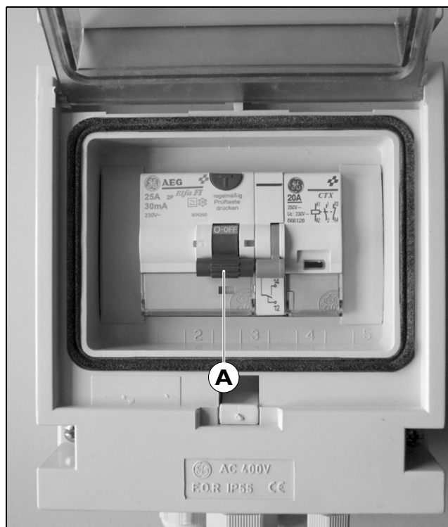
[291] RCD-Box im Fahrerhaus, Fehlerstromschutzschalter (A) in Stellung OFF
