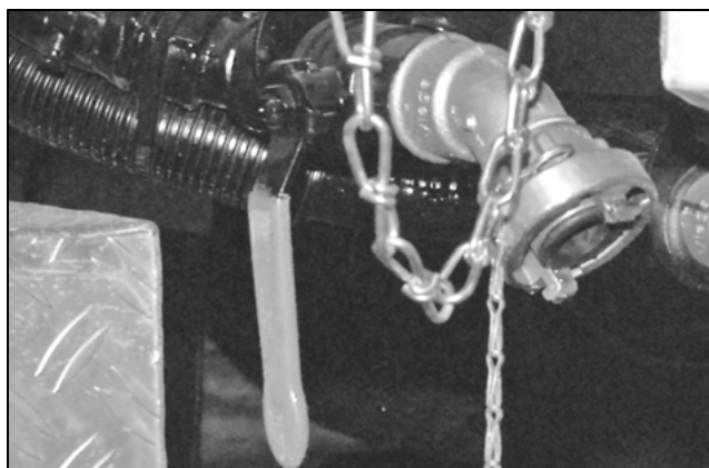
[58] Tankentleerleitung mit manueller Betätigung (Tank füllen nicht zulässig)
